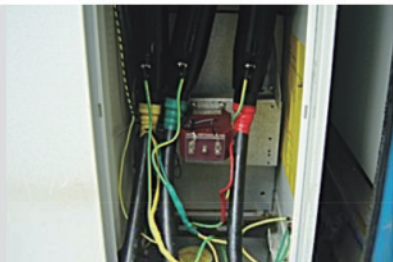
旁路作业辅助电缆 (安装螺栓连接T型终端) 用于旁路作业系统与环网柜、 电缆分支箱电气连接。
